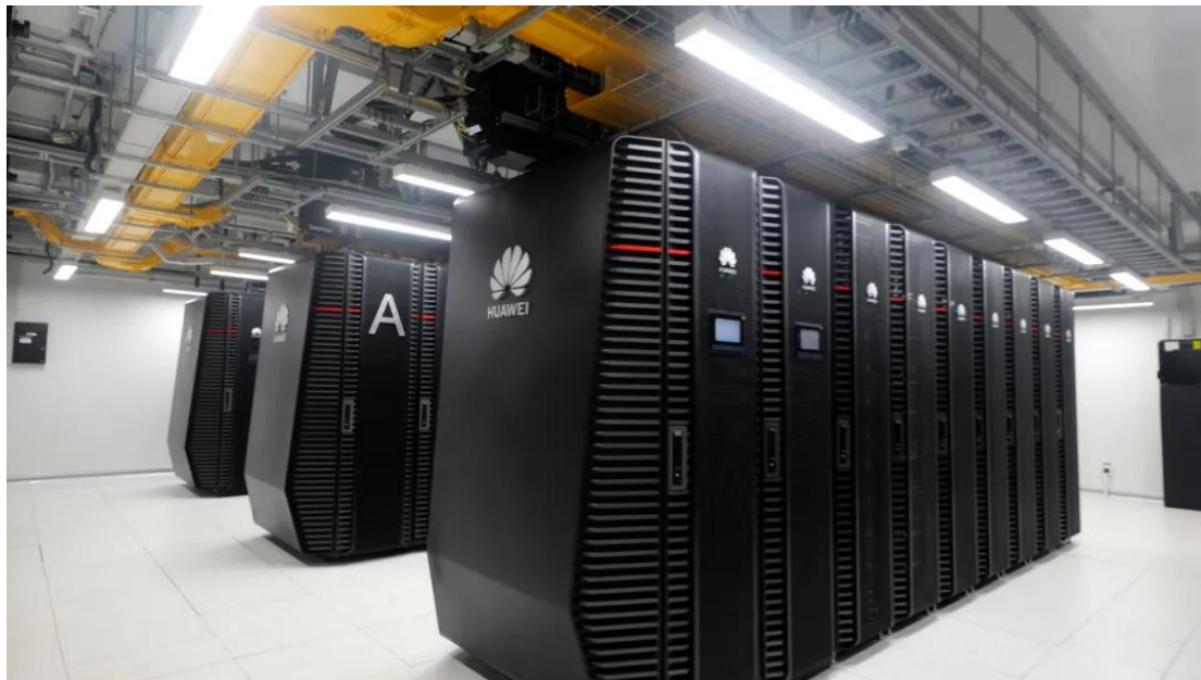
图 1-1 沈阳人工智能计算中心算力中心机房
